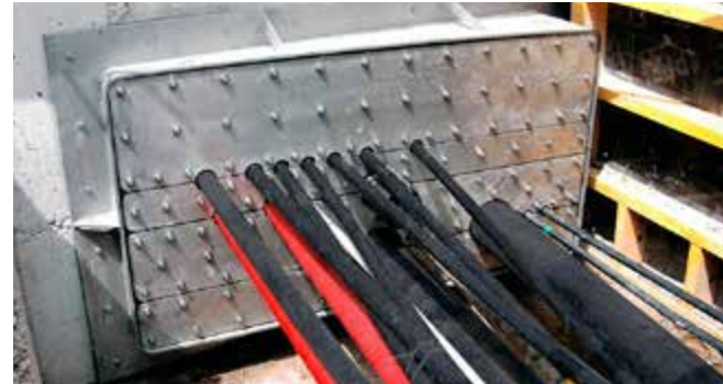
Zastosowano kołnierz stalowy z gumowym wkładem uszczelniającym w wykonaniu dzielonym.
