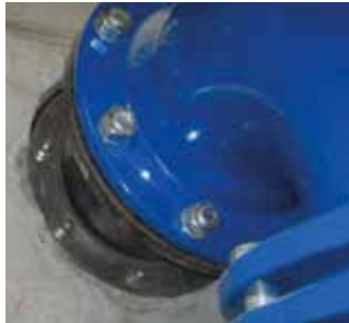
HRD 250-1G-1/210 główne zasilenie wody
