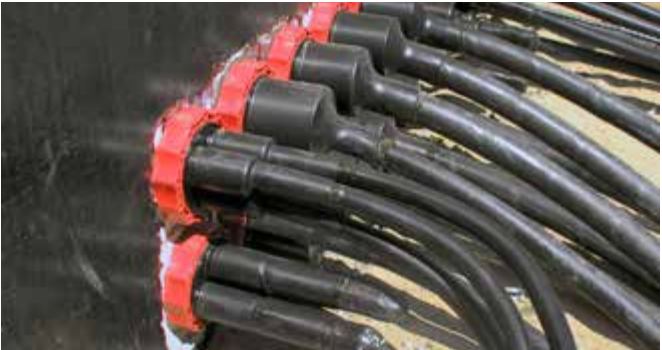
Stacja kontenerowa, kable niskiego napięcia uszczelnione pokrywami HSI 90-D1/75 i HSI 90-D3/32
