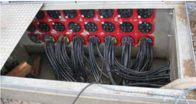
HSI 150 - uszczelnione przewody sterujące w stacji kontenerowej
