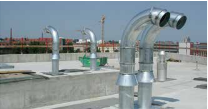
Zamontowane przepusty SHD 200, bez kabli
