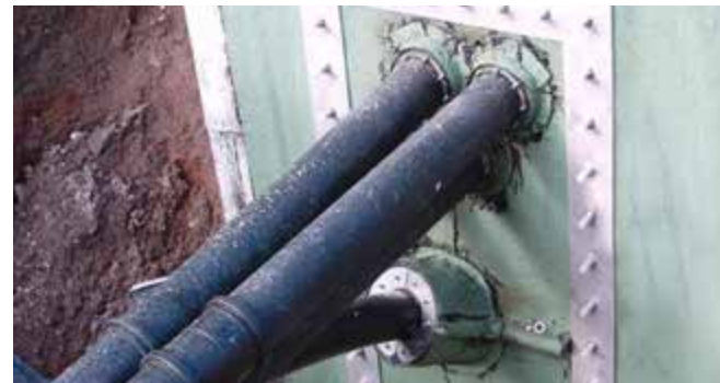
Zastosowano kołnierz stalowy i gumowe wkłady uszczelniające zgodnie z normą DIN 18195.
